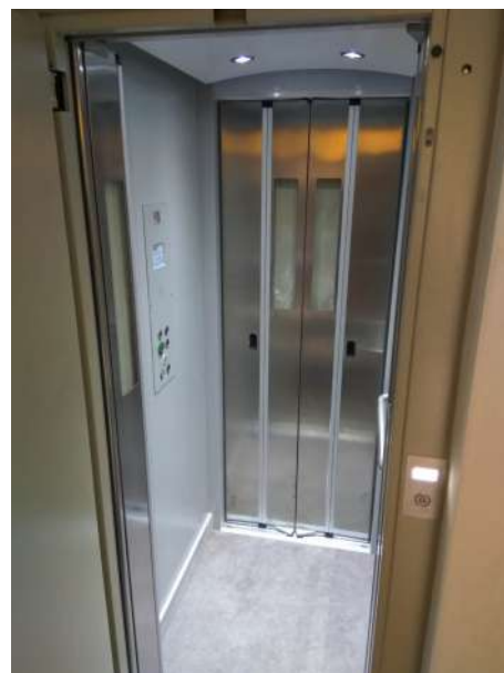
PUERTA BUS EN CABINA
